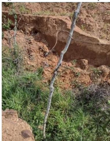
Figura 3A. Talude instável - solapamento
